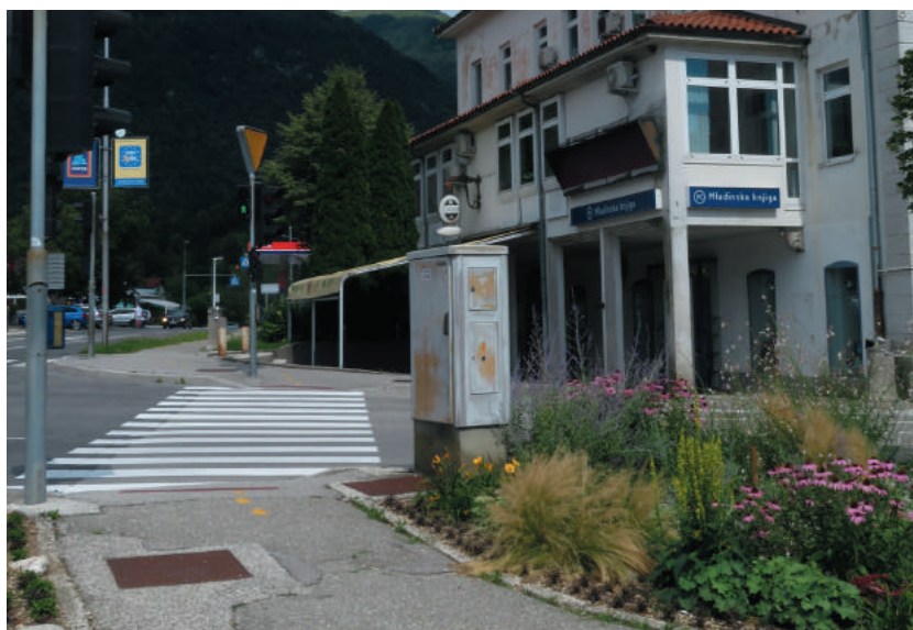
izpostavljena elektro omara ob prehodu za pešce Foto: julij 2020
