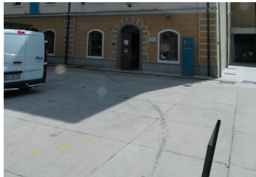
Poškodbe in madeži na betonskem tlaku Foto: julij 2020
